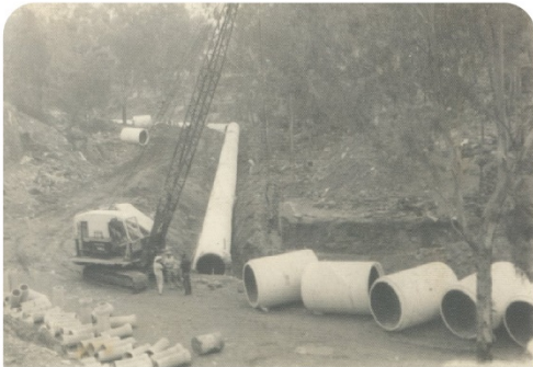
Años 1970. Entuban río Tecamachalco y desplazan a habitantes de la barranca a San Juan de Aragón
